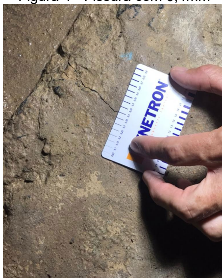
Figura 4 - Fissura com 0,4mm
