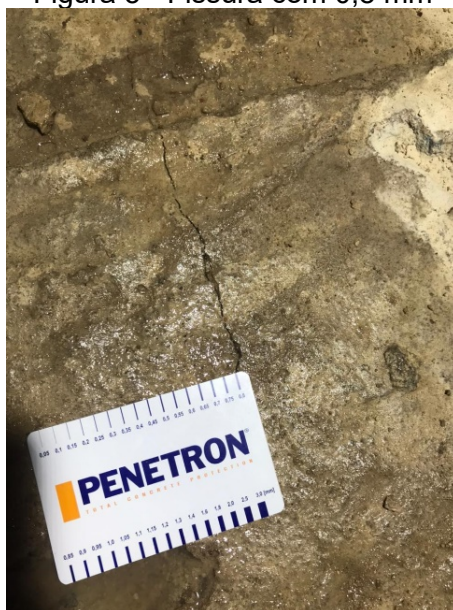
Figura 5 - Fissura com 0,8 mm
