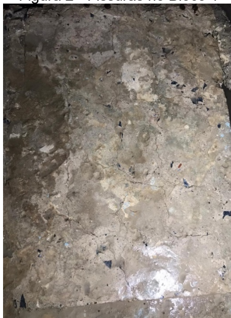
Figura 2 - Fissuras no Bloco 1
