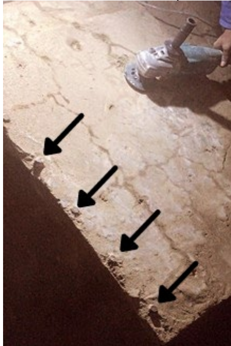
Figura 3 - Fissuras e armadura exposta no Bloco 1
