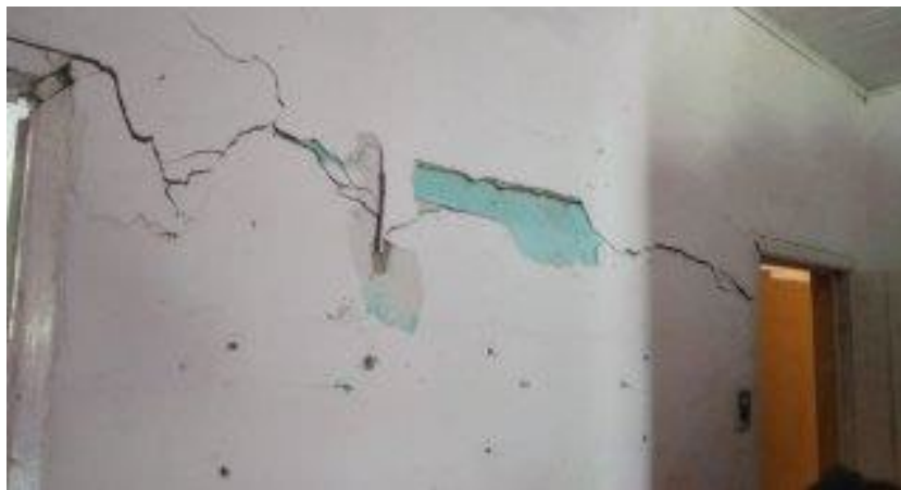
Figura 2 - Parede interna com fissuras horizontais
