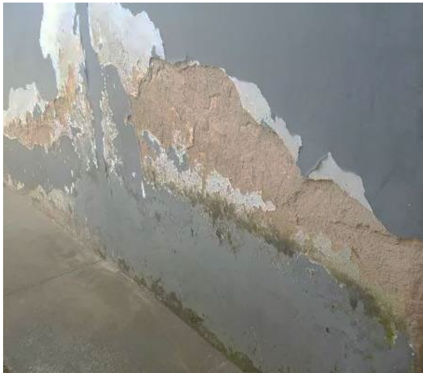
Figura 7 - Infiltração na parede devido a tubulação hidráulica da cozinha
