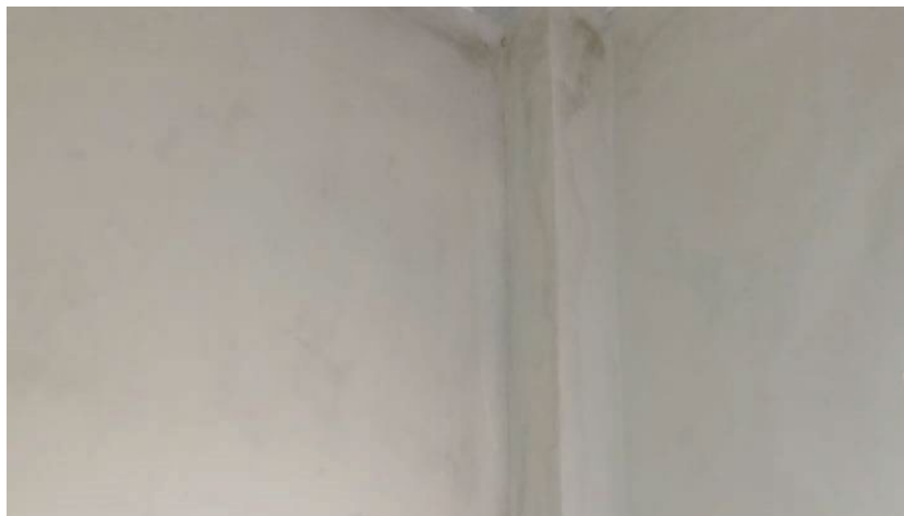
Figura 4 - Umidade na parede
