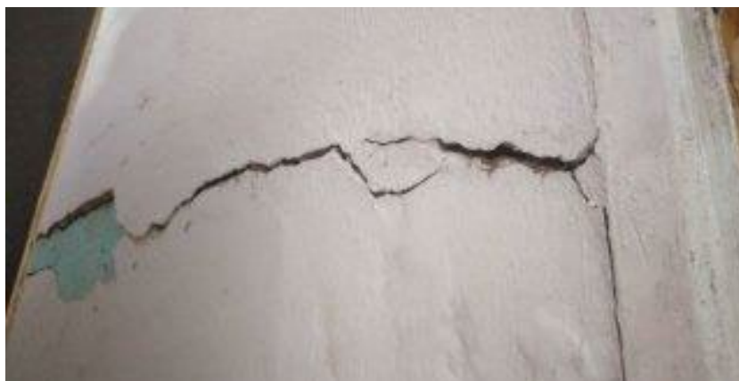
Figura 3 - Parede interna com fissuras horizontais
