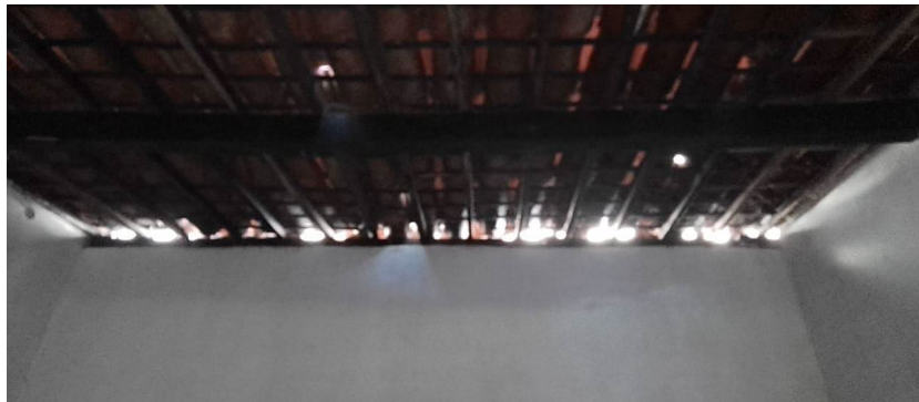
Figura 6 - Gotejamento de água pluvial no telhado existente
